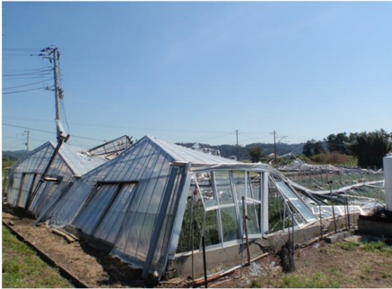
倒壊した鉄骨ハウス（富浦町青木）
