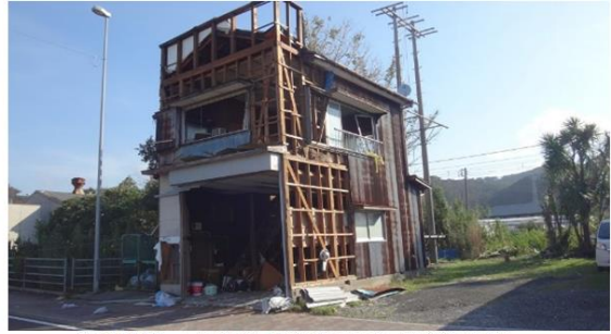
突風被害により全損した消防団詰所（富浦町原岡）
