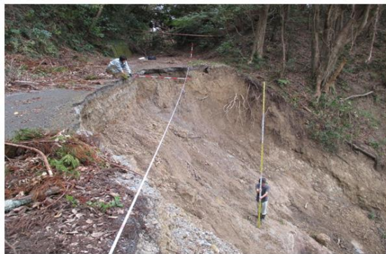
路肩が大きく欠損した嶺岡中央林道（富山地区井野）
