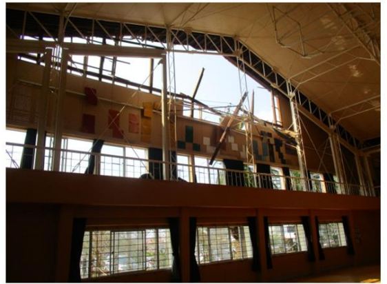
壁が大破した体育館（富浦中学校）
