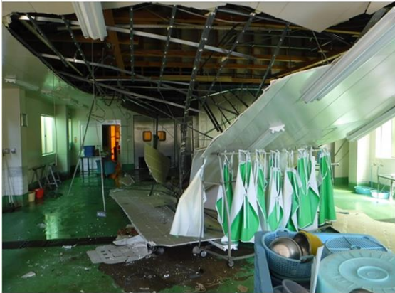
大きく被害を受けた水産加工場（千倉町千田）
